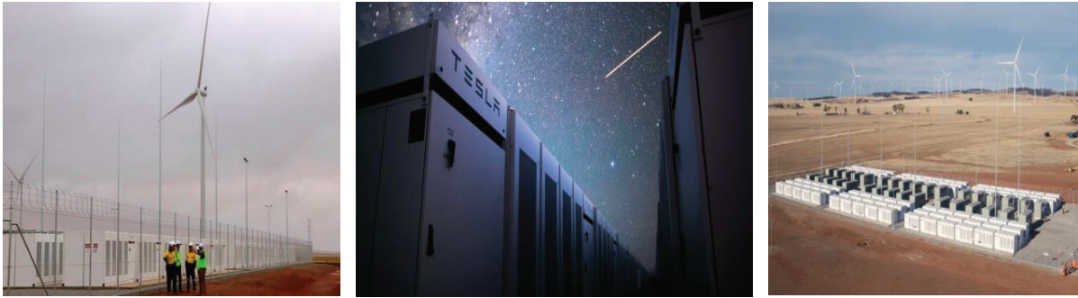
Рис. 2. Акумуляторна батарея Hornsdale Power Reserve, The Hornsdale windfarm (ветряная ферма Хорнсдейл)
