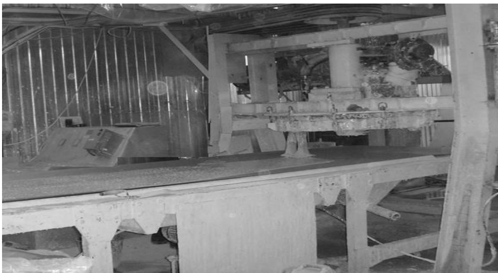
Рис. 4.7. Фрагмент технологічного обладнання, яке забезпечує процес підготовки гіпсоводної суміші та подачі на формувальний стіл
