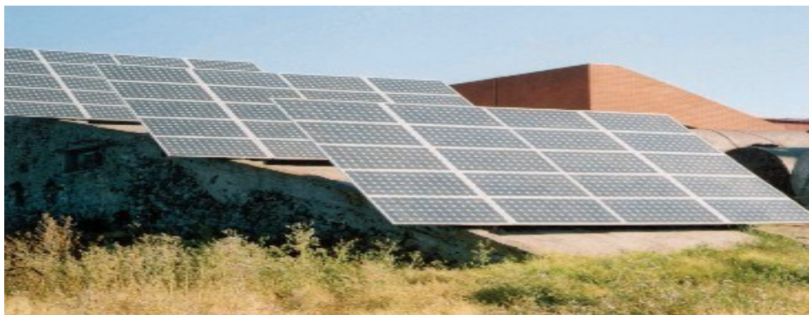
Рис. 4.4. Фотоелектрична система енергопостачання на о. Зміїний потужністю 10 кВт
